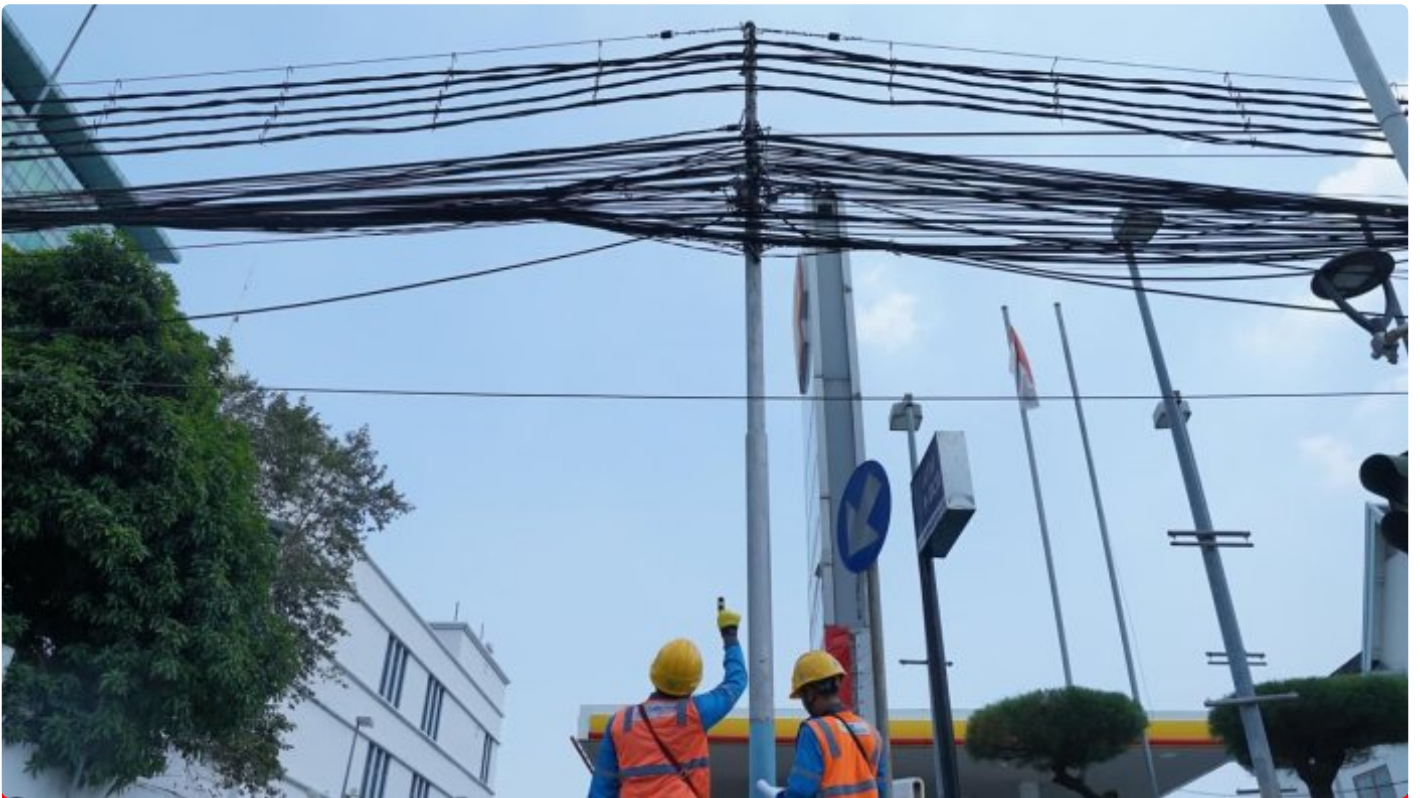
Photo: Titik Lokasi pencuri Kabel PLN
